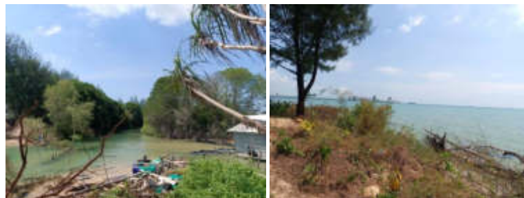
Gambar 17 Kondisi Pesisir Pantai Socorejo Akibat Erosi Pantai Socorejo pada Mei 2022
