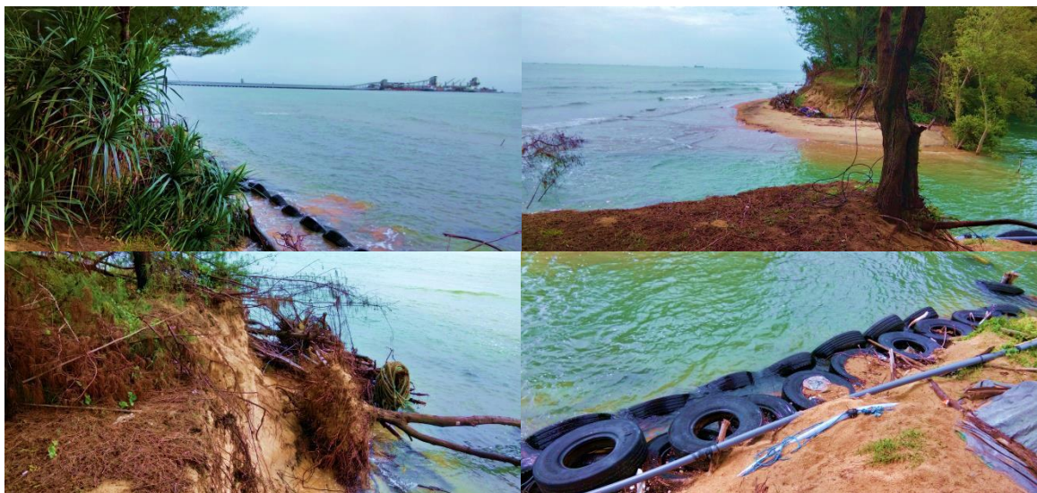
Gambar 15 Kondisi Pesisir Pantai Socorejo Akibat Erosi Pantai Socorejo pada Mei 2021 (Sumber: Dokumentasi Kegiatan)
